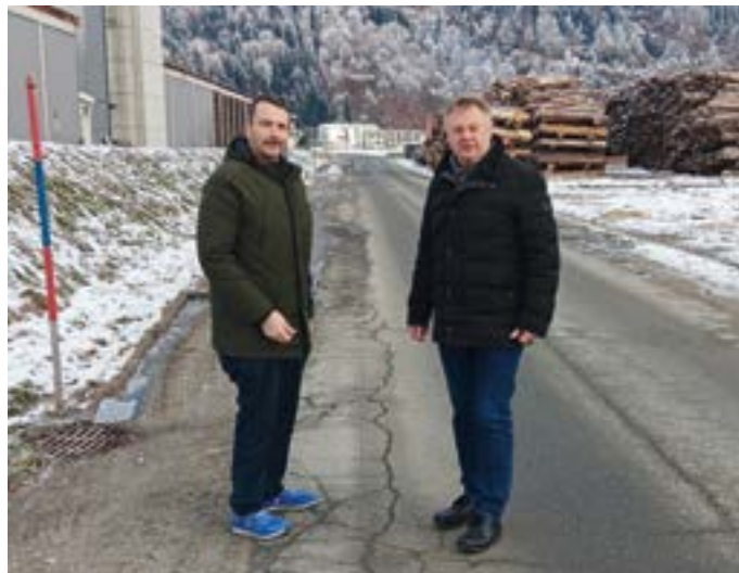
Die Erhaltung der Gemeindestraßen gehört zu den Pflichten der Gemeinde. Für 2024 geplant: Bürgerfeldstraße
